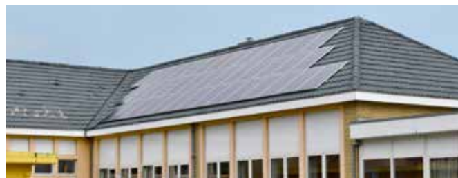
Panneaux solaires à l'école de Vivegnis
